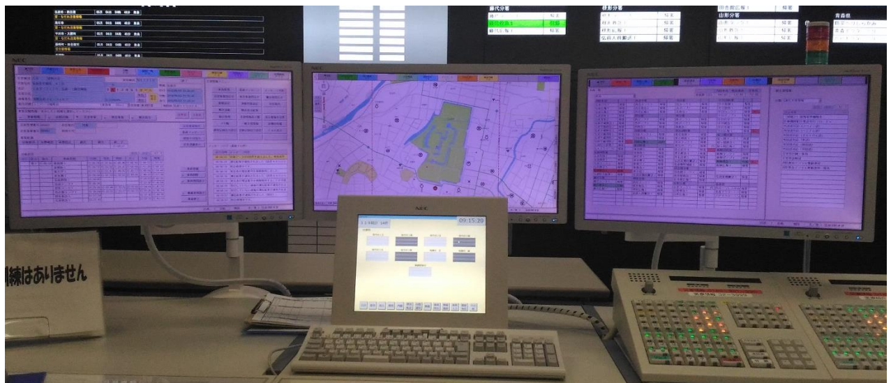
指令センター内指令台画面状況
